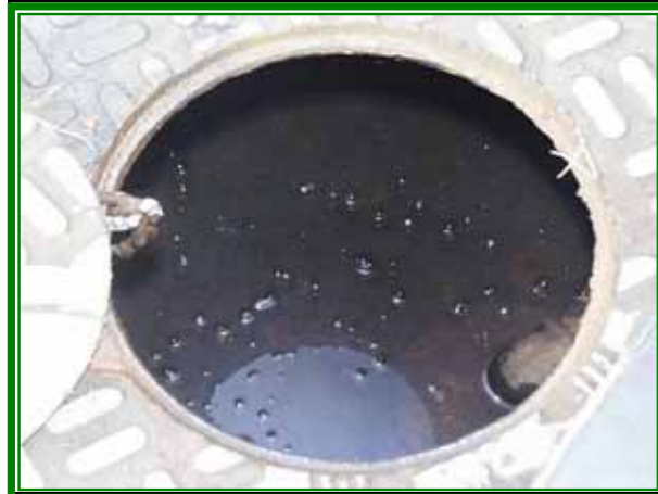
油槽內浮油及油花
