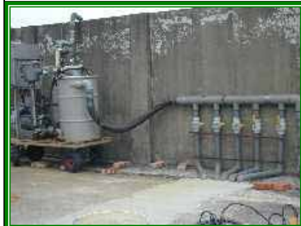
加油站 SVE 回收設備
