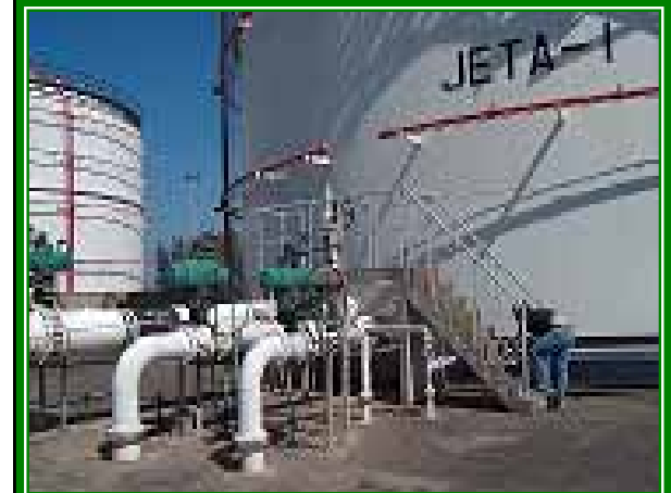
儲槽管線出入口
