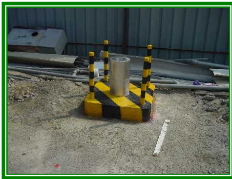
照片 4-1 標準式地下水監測井
